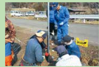
農家団体による電気柵の設置
