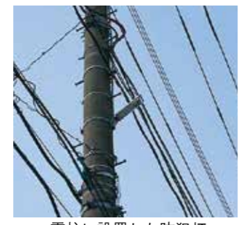
電柱に設置した防犯灯
