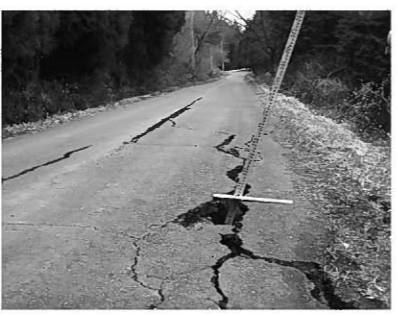
道路の至る所で亀裂が生じた
