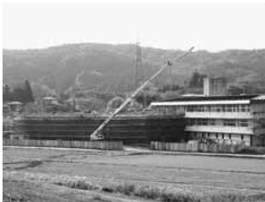
現在、既存校舎南側に建設中の新校舎南棟。2階部分の工事が行われており、徐々に新しい校舎の姿が見え始めました。(10月22日撮影)
