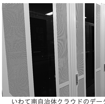
いわて南自治体クラウドのデータセンター
