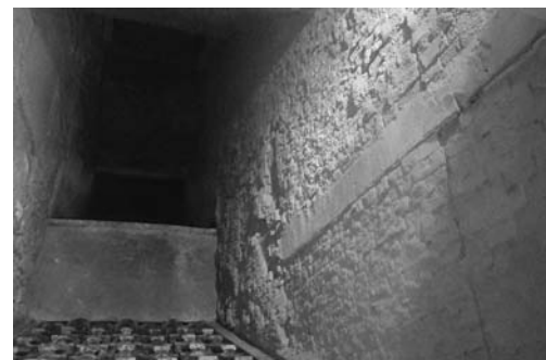
壁のレンガが損傷した焼却炉本体内部
