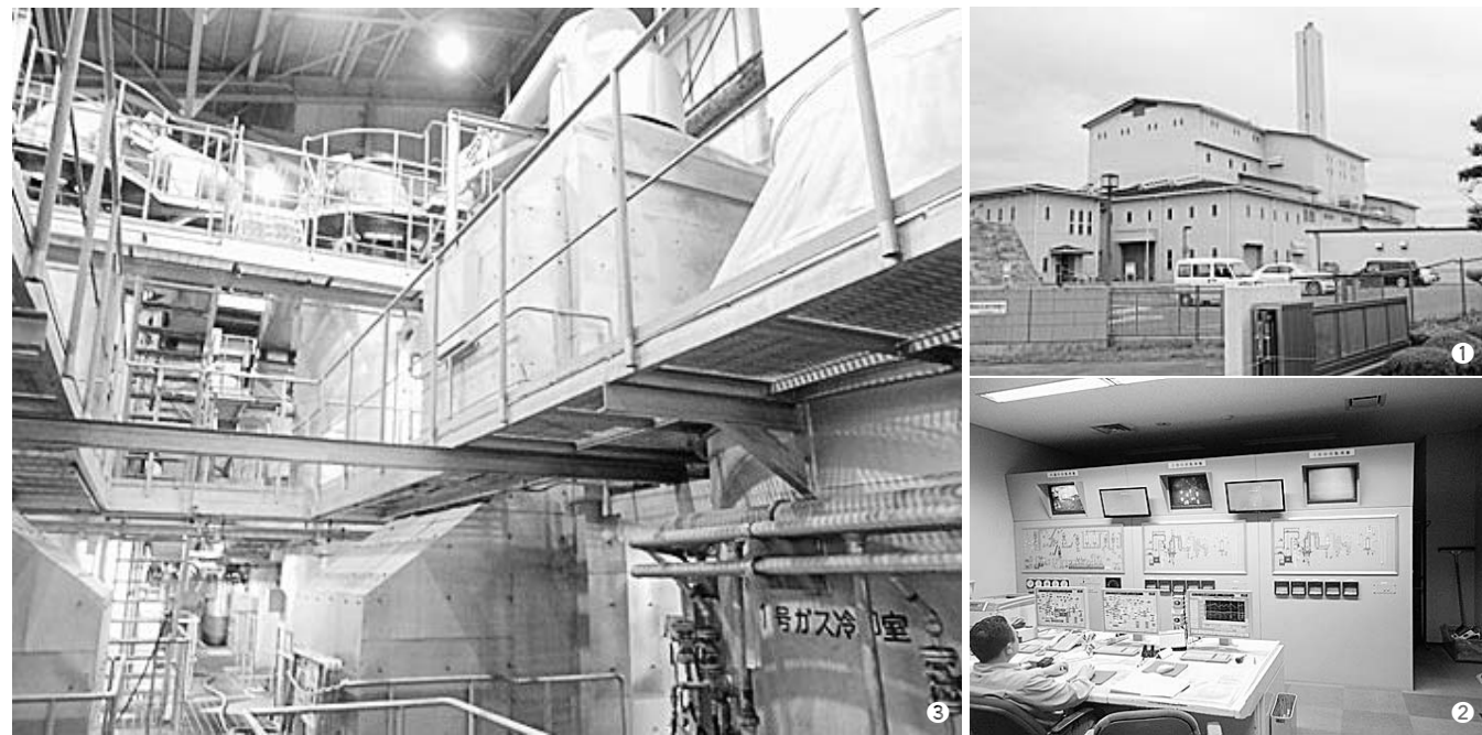
① 大東清掃センターは稼働してから19年が経過／② 大東清掃センターの中央制御室。ここで焼却炉内部などに異常がないかを確認している／③ 集じん器や活性炭などを使って排ガスをきれいにしている。これらの装置の維持費にも多額の費用がかかる。写真は大東清掃センター
