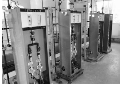
平泉浄水場薬品注入機
