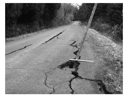
道路の至る所で亀裂が生じた
