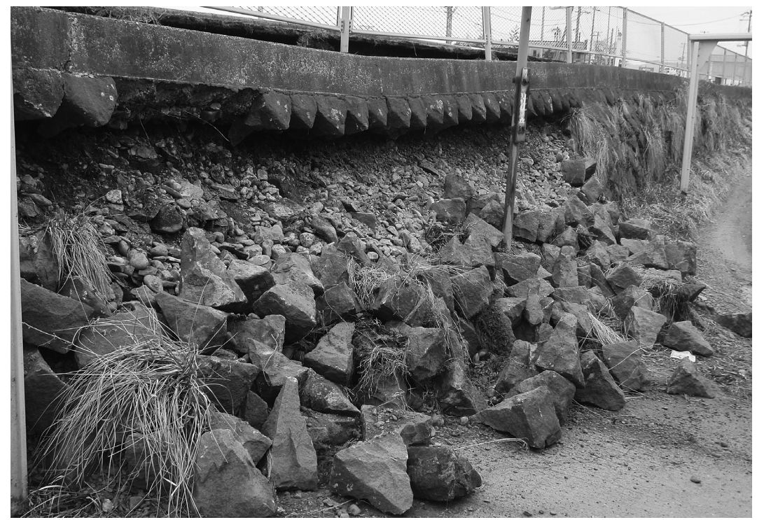
石垣ブロックが崩落した県道一関平泉線(大佐地内)
