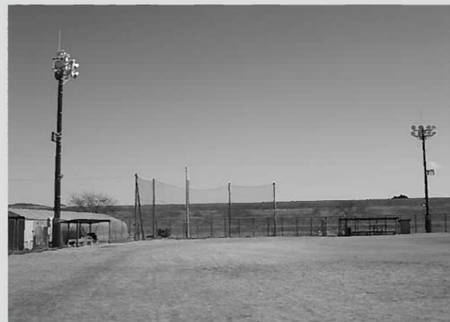
完成した平泉中校庭照明施設
