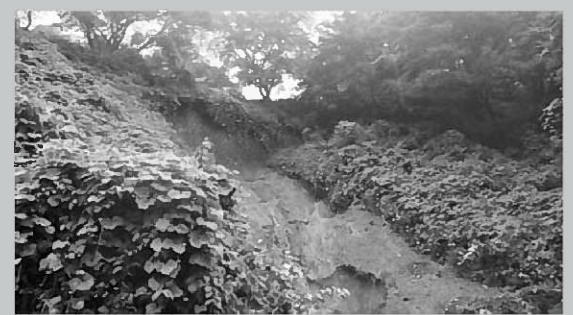
法面が崩落した大沢地内
